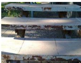
После чистки от ржавчины
